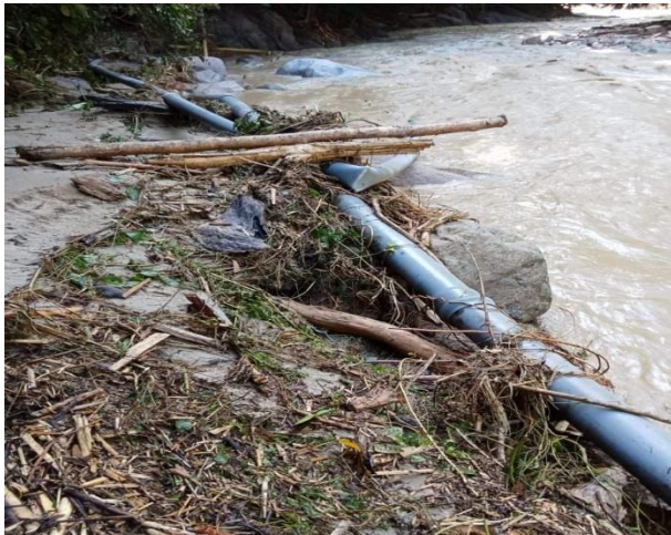
Gambar 4. Kerusakan Pipa Air Bersih (Sumber : Dokumentasi FB)
